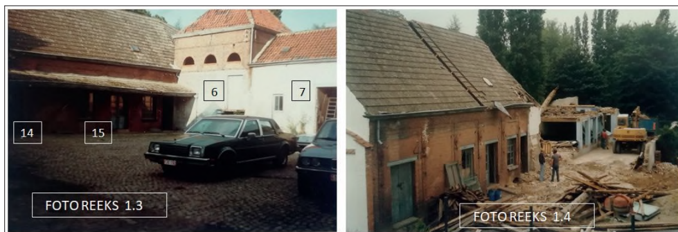
Foto 1.3 Voor de afbraak en renovatie Foto 1.4 Afbraak: december 1984 Nr 6 Oude drooggeest en mouterij. 7 Magazijn. 14 Bottelarij. 15 Magazijnen volle en lege kratten.
